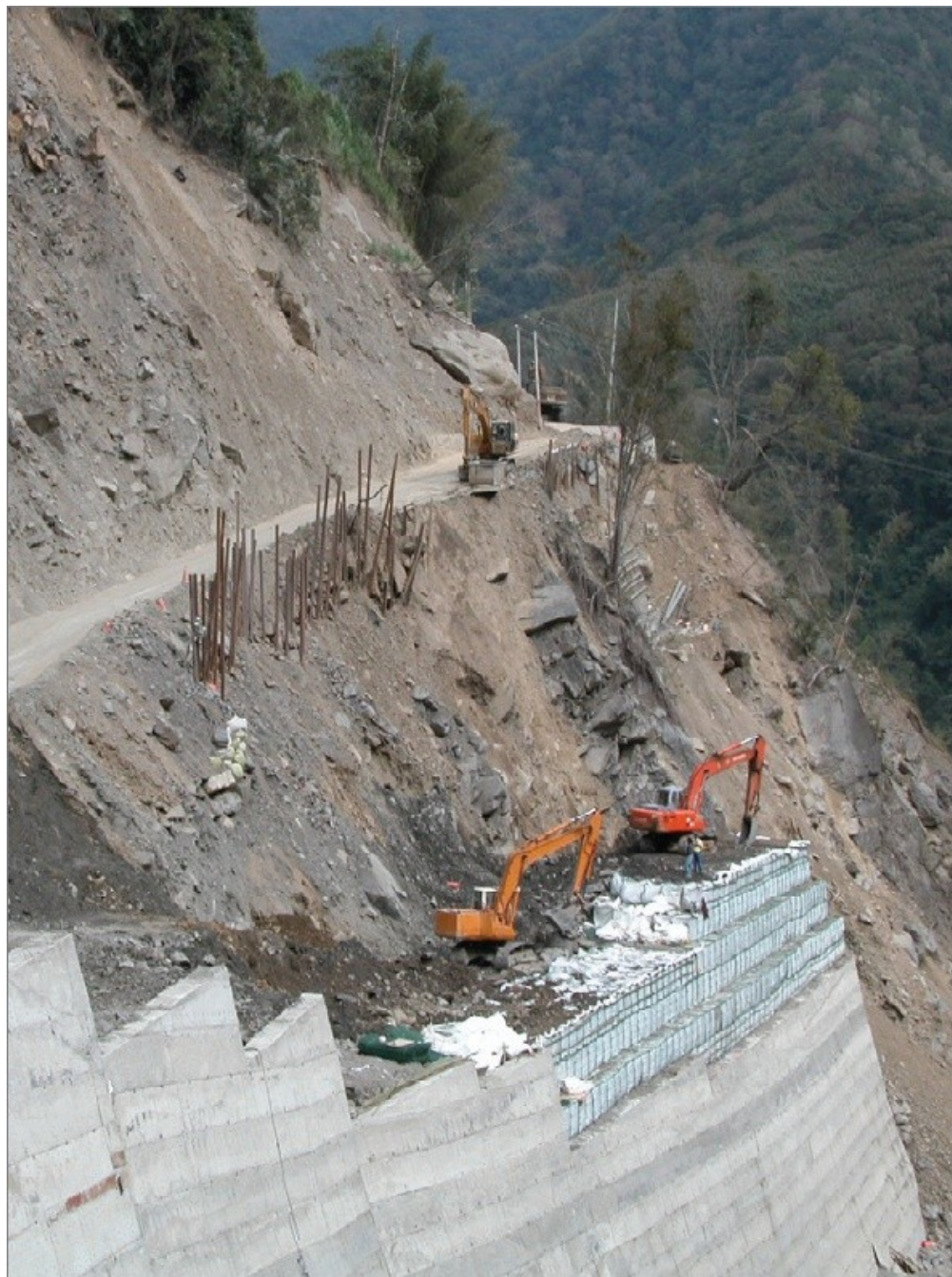
圖 4-7 在山坡上開發應設擋土牆，以保安全（攝於北橫）
